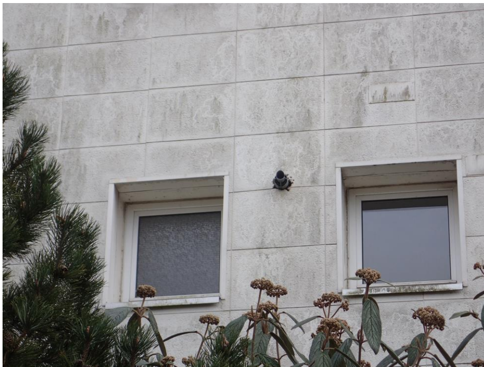
Nid de Mésange bleue façade côté jardin dans la fissure de la bouche d'aération
