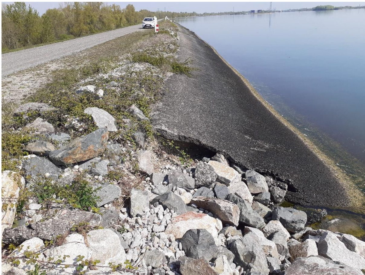
Figure 4 – Revêtement en béton bitumineux endommagé
