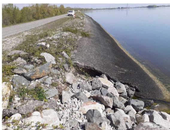
Figure 2 : Morceau de berge endommagé (source : DLE, VNF 2021)
