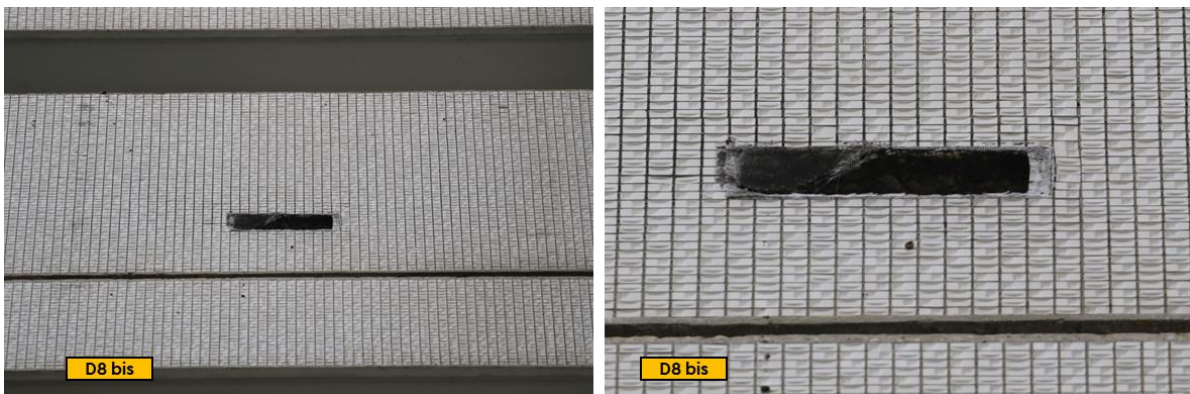
Ci-dessus, vues d'une bouche d'aération dépourvue de grille extérieure - observée en façade n°8 du bâtiment D – 21 mai 2025 - Source : ©J. MIROIR-ME 2025
