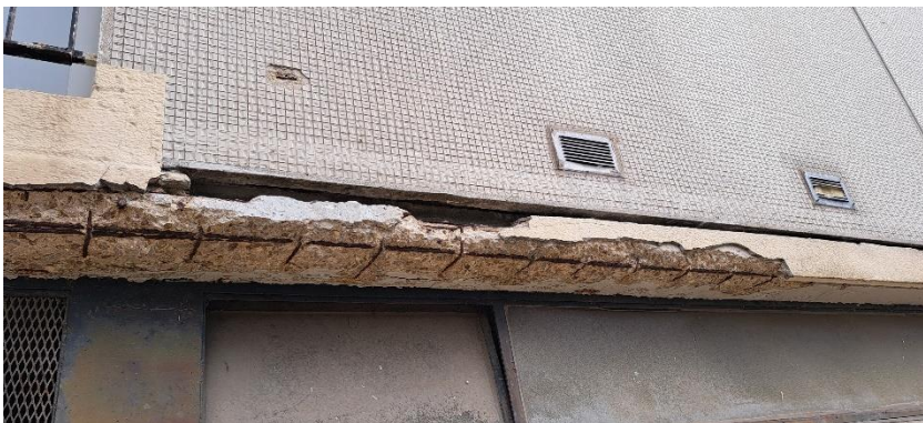
Ci-contre, exemple d'anfractuosité présente en façade n°3 du bâtiment A – mercredi 21 mai 2025 – Reims (51) ©J. MIROIR-ME 2025
