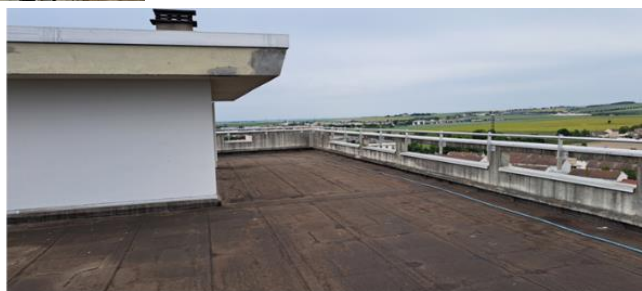
Ci-contre, vues des toits terrasse pourvu de plaques bitumineuses du bâtiment D – prise de vue à partir des toits – mercredi 21 mai 2025 – Reims (51) ©J. MIROIR-ME 2025
