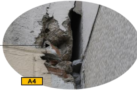
Ci-contre, anfractuosité accentuée observée sur la façade du bâtiment A4 – 21 mai 2025 - Source : ©J. MIROIR-ME 2025.
