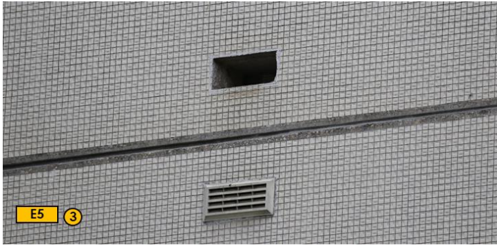
Ci-contre, vue d'une bouche d'aération dépourvue de grille extérieure - observée en façade n°5 du bâtiment E - 21 mai 2025 - Source : ©J. MIROIR-ME 2025
