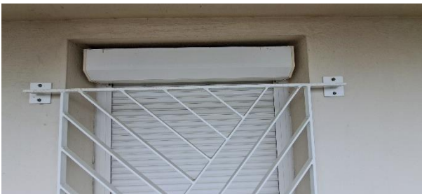
Ci-contre, vue de détail par-dessous d'un caisson de volet roulant permettant de voir ses caractéristiques structurelles et sa configuration extérieure – mercredi 21 mai 2025 – Reims (51) ©J. MIROIR-ME 2025
