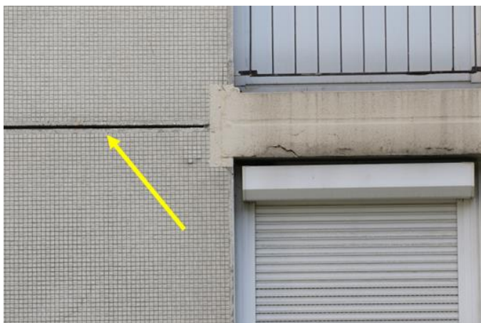
Ci-contre, vue d'un disjonctement de façade - observées en façade n°4 du bâtiment C - 21 mai 2025 - Source : ©J. MIROIR-ME 2025.
