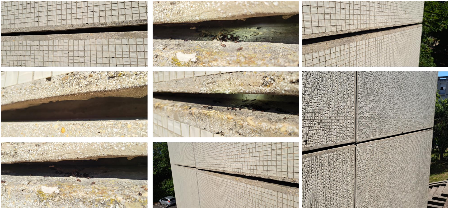
Ci-dessus, vues de différents disjointements de façades occupés ou non par des Pipistrelles communes – 10 juillet 2025 - Source : ©J. MIROIR-ME 2025.
