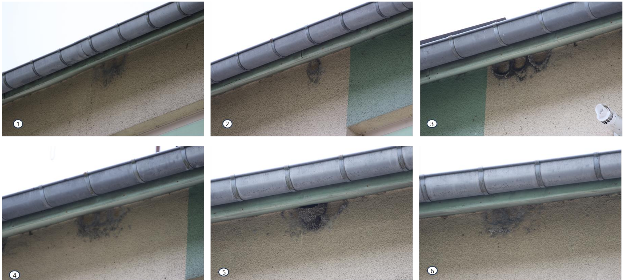
Ci-dessus, vues de détail des traces de nids observés au niveau de la façade Est de la résidence n°2 – 16 mai 2024 – Ligny-en-Barrois (55) ©J. MIROIR-ME 2024
