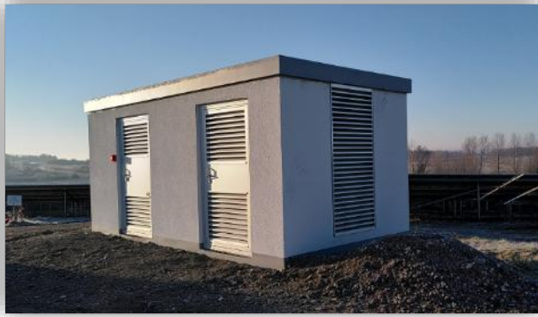
Figure 2 : poste de transformation remblayé
