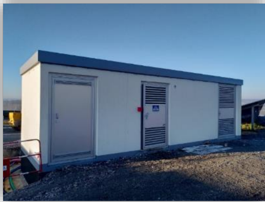
Figure 3 : Poste de livraison
