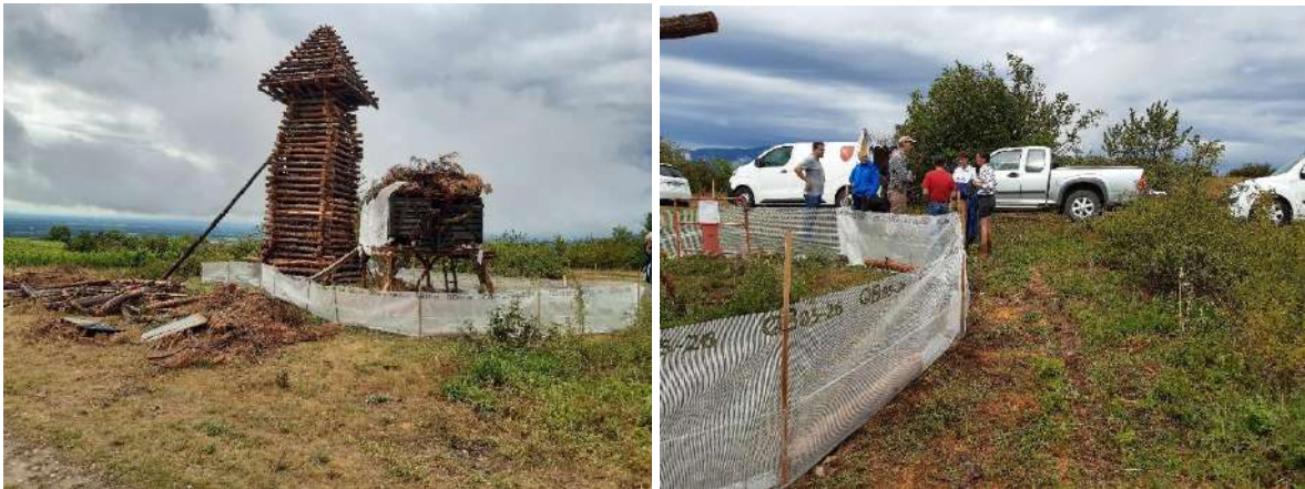
Installation d'une barrière physique afin d'éviter l'installation d'un Lézard vert au sein du bûcher, le 27 juin 2022
