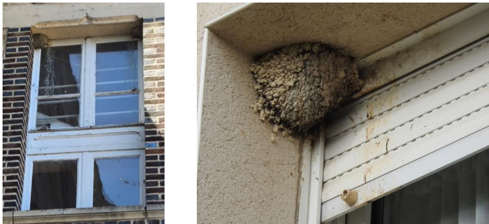
Figure 5 : Exemples de nuisances causées par les nids : salissures des fenêtres et dans les chambres, difficulté voire impossibilité de fermer les fenêtres.
