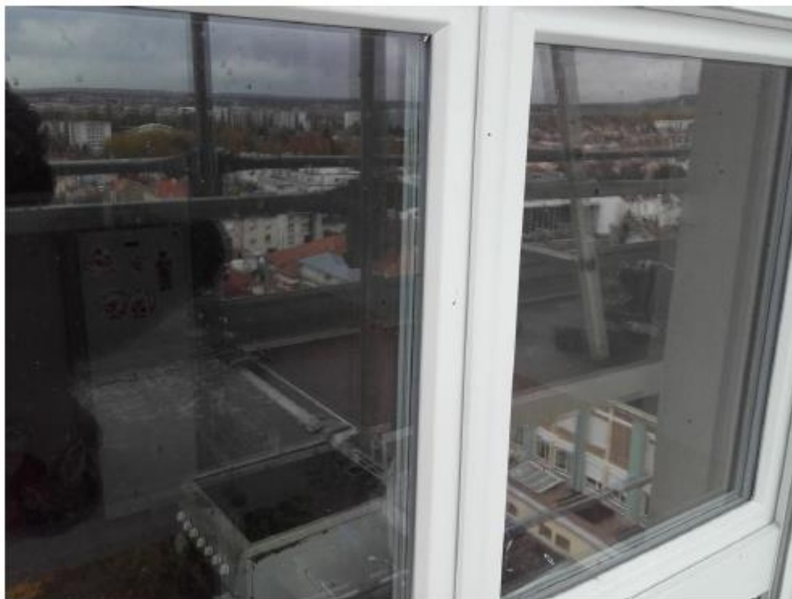
Figure 6: guano de Pipistrelle commune sur une fenêtre montrant l'activité récente
