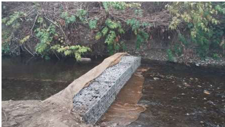
Figure 49 : Exemple de filtre à Matières En Suspension (MES) formé de Gabions - Illustration BE Sinbio
