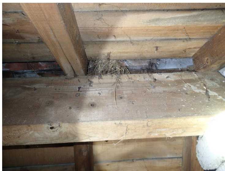
Nid de Moineaux domestique sur la poutre faîtière du comble
