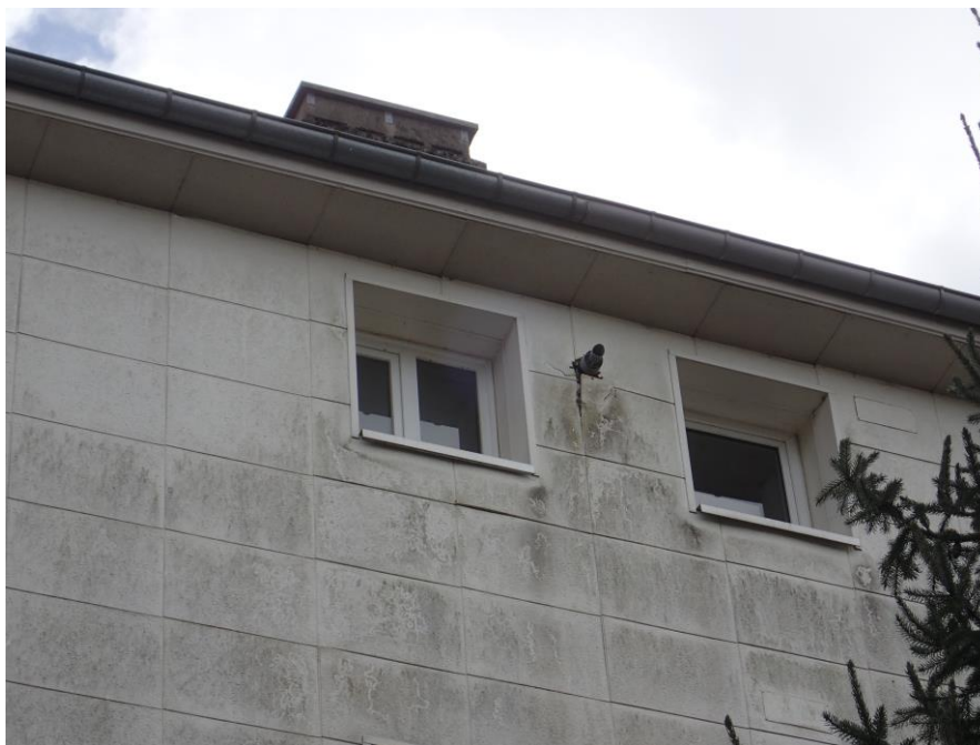
Nid de Moineau domestique façade côté jardin dans la fissure de la bouche d'aération
