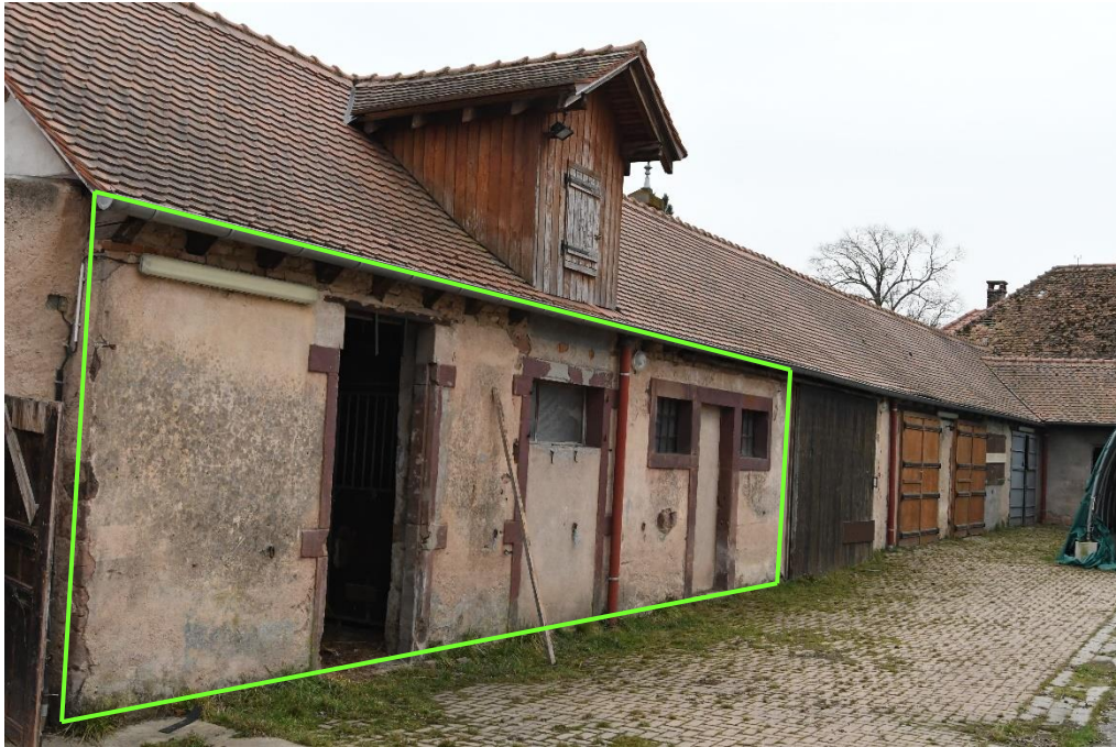
Photo 6 : Conservation de deux parties de la dépendance pour la nidification de l'Hirondelle rustique
