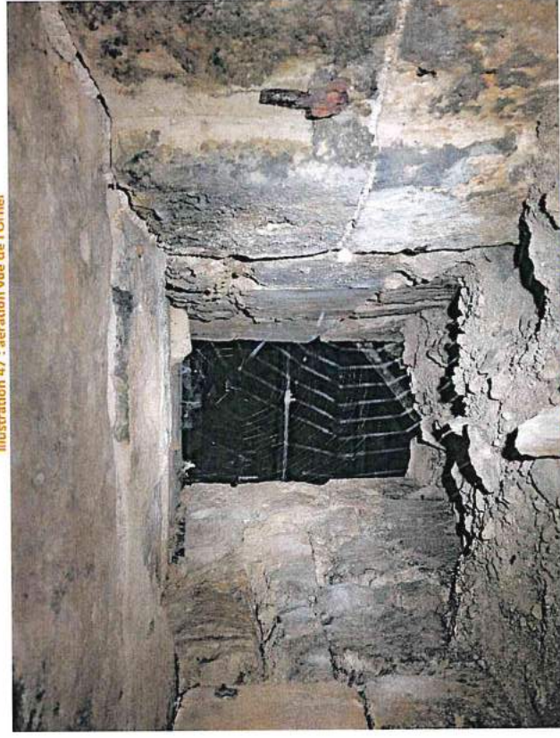
Illustration 48 : aération vue de l'intérieur
