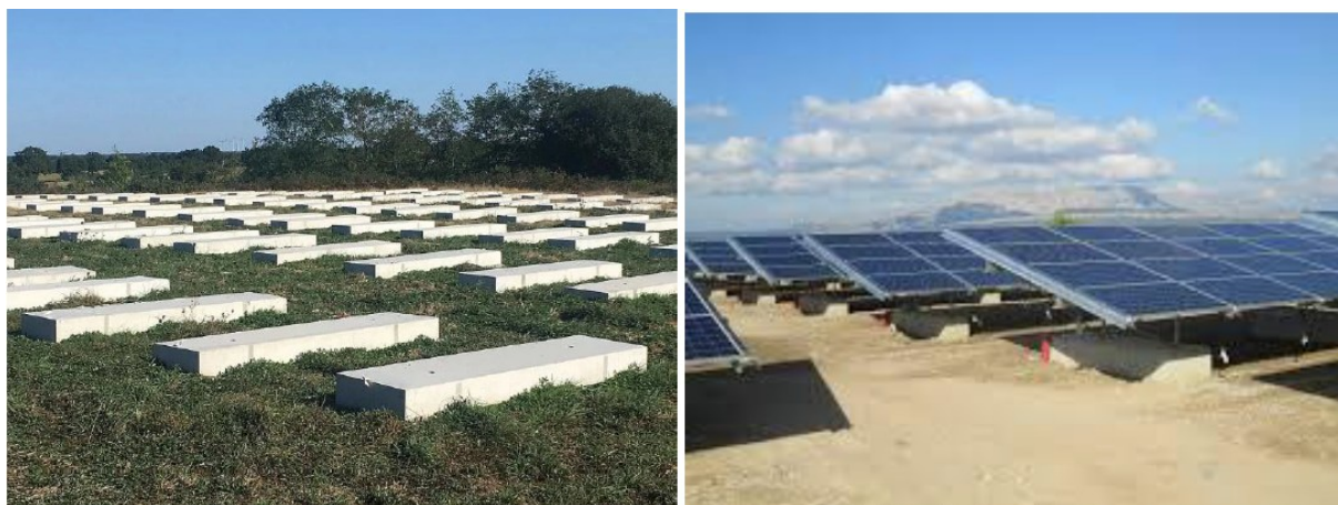
Figure 7 – Photographie d'une centrale photovoltaïque au sol – tables et ancrage au sol (© Électricité d'Azur)
