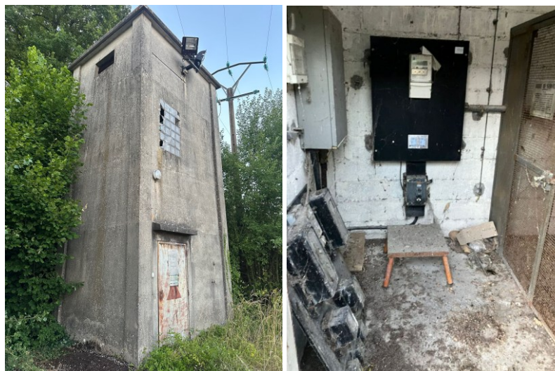
Photo 66 – Bâtiment électrique localisé au nord du périmètre du projet (©Alisea/ Électricité d'Azur))
