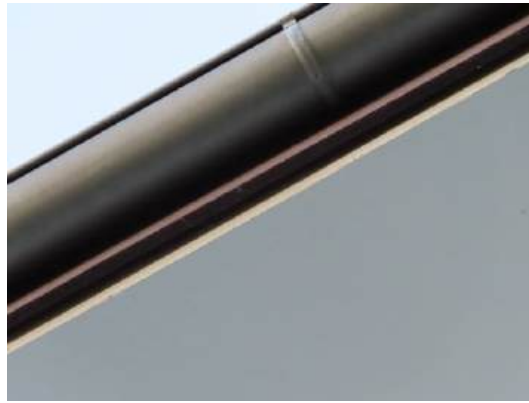
Figure 14 : Disjointement potentiellement favorable en façade nord-ouest du bâtiment 7
