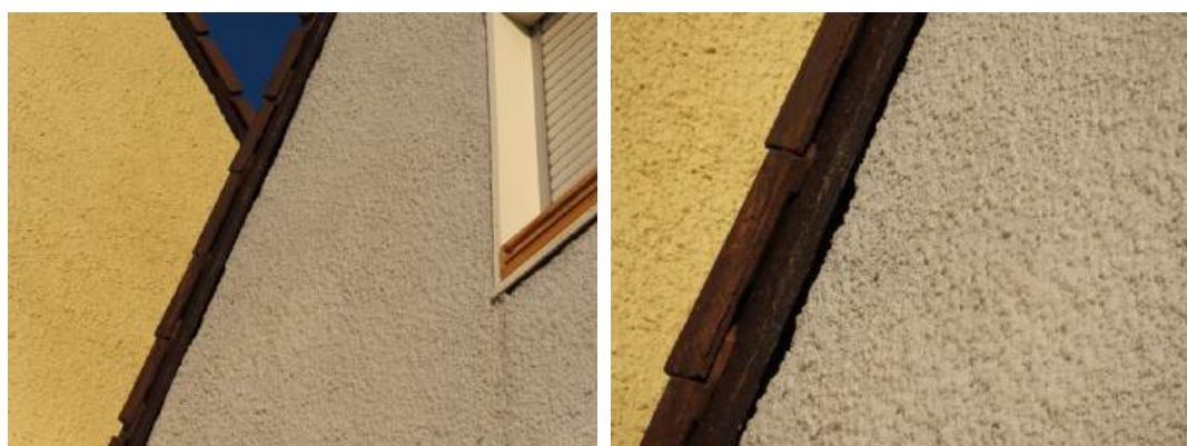
Figure 7 : Disjointement potentiellement favorable en façade nord-ouest du bâtiment 3
