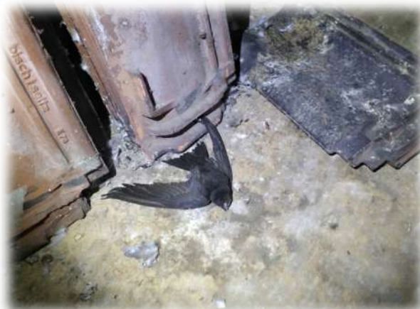
Figure 1 : cadavres de Martinet noir ( Apus apus ) observés dans les combles du bâtiment C de la Cité administrative de Mulhouse. Mulhouse, octobre 2019.
