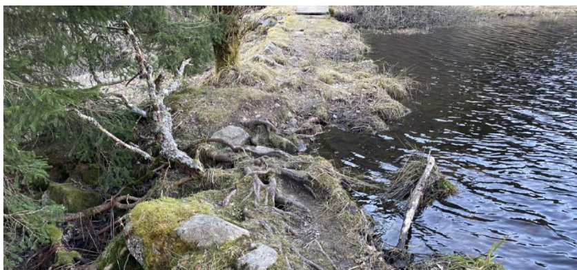
Photographie 1 : Présence de signes de dégradation de l'ouvrage transversal (source : Biotec)
