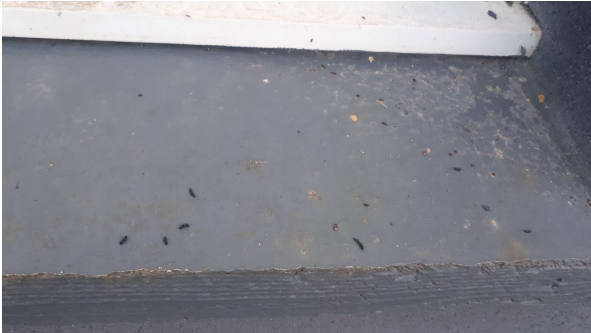
Photo 6 : guano isolé sur un appui de fenêtre du bâtiment, sous un volet roulant
