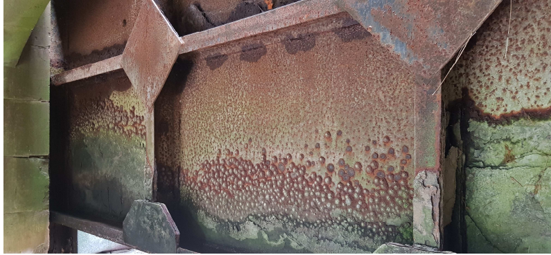
Etat dégradé de la vanne de l'ouvrage
