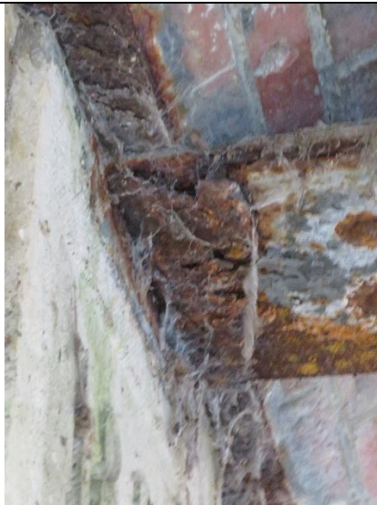
Corrosion et feuilletage sur appui
