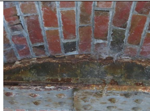
Corrosion et feuilletage sur la poutre principale
