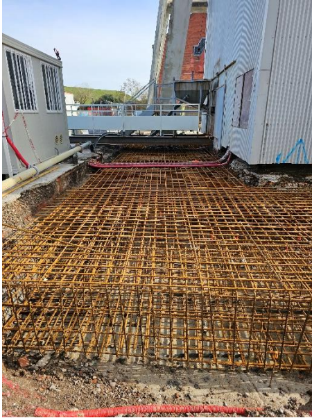
Le ferrailage du radier béton sur 1 m d'épaisseur défini par un bureau d'étude en structure
