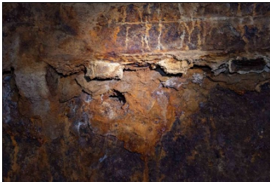
Corrosion très avancée du cuvelage
