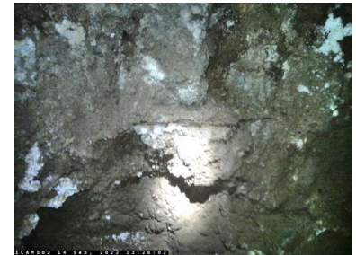
Corrosion profonde et éclatement du béton
