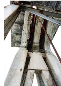
Fissure dans un pilier du chevalement, vue du dessous de la plateforme sommitale
