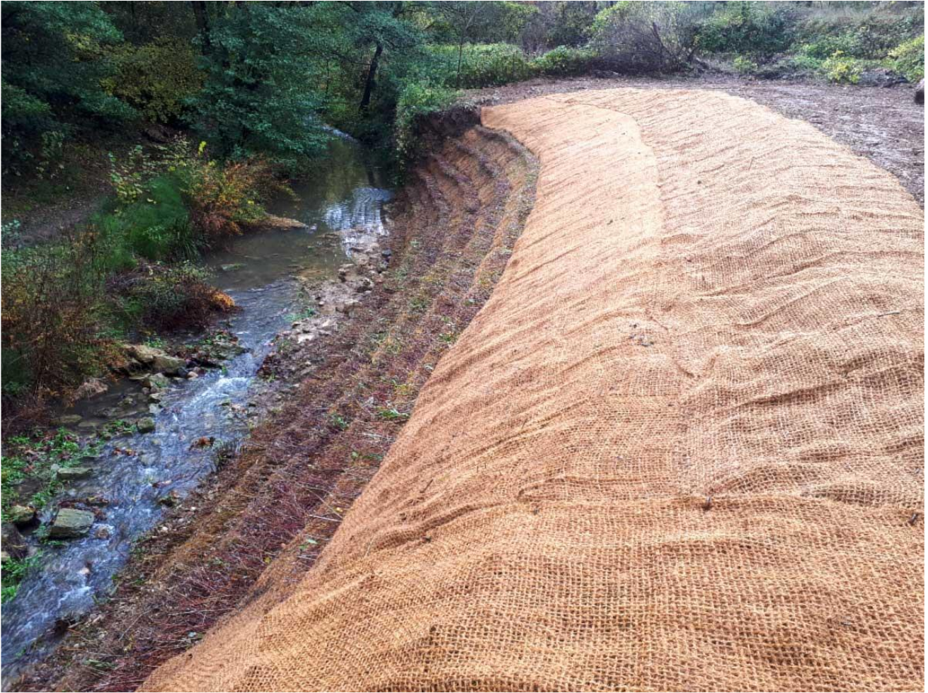
Figure 19- Confortement de berge avec des lits de plants et plançons (Source : La Compagnie des Forestiers)
