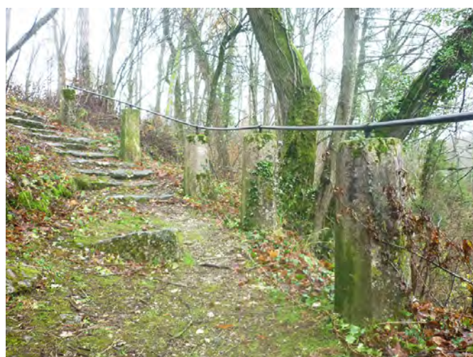
Lices sur borne en calcaire. Un dispositif dégradé à reconduire dans le cadre d'une rénovation de l'ouvrage.
