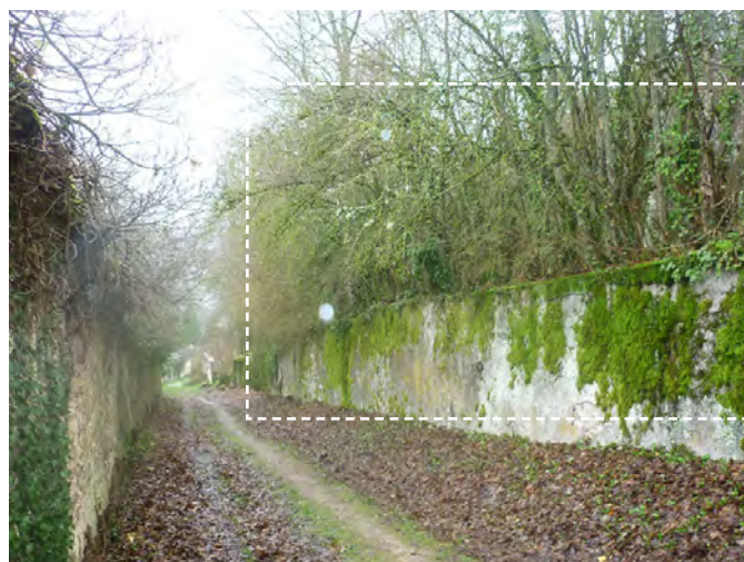
Les arbres situés au contact des maçonneries doivent être abattus et dessouchés notamment pour les essences qui rejettent comme l'érable ou l'acacia.
