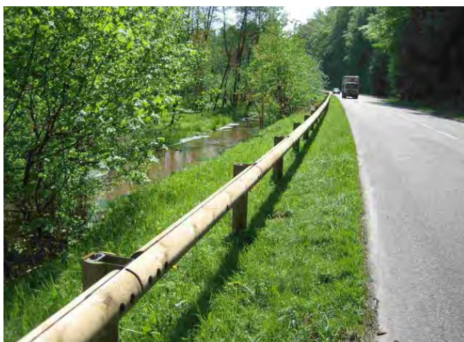
Les glissières de sécurité en acier galvanisé ont un impact certain sur la perception du paysage de la vallée, notamment dans la séquence de seuil urbain où elles ont été installées. Un remplacement par un équipement revêtu de bois, atténuerait déjà leur présence.
