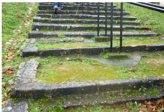
État du grand escalier entre la rue du Calvaire et la grotte du Christ gisant.
