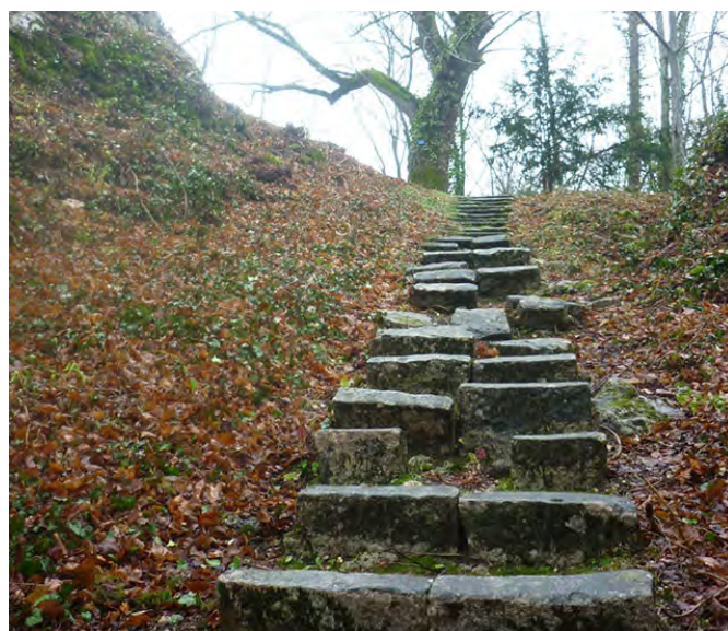
État du second escalier. Le promeneur circule de fait sur le côté de l'ouvrage pour échapper au chaos.
